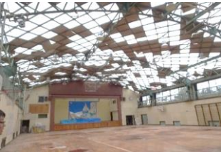
台風で屋根が消失した体育館
