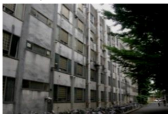
落下の危険がある外壁
