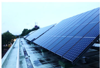
創エネルギー設備の整備
