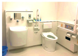
バリアフリートイレの整備
