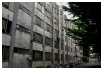
落下の危険がある外壁
