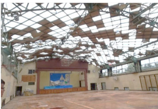
台風で屋根が消失した体育館
