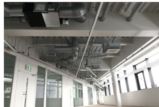
高効率空調の整備
