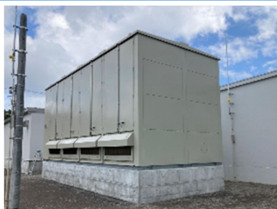
大容量大型蓄電池パッケージ
