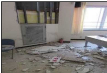
地震による内部破損
