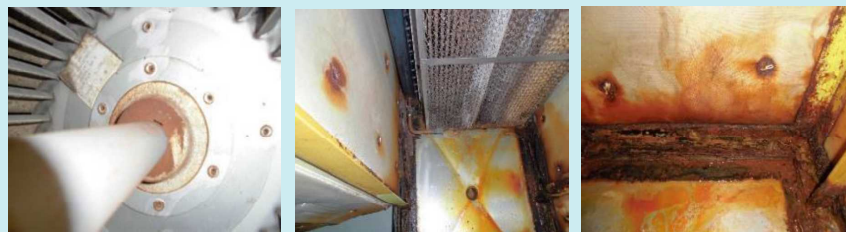
空調機器内部底面のフレーム部及び給気ファンの腐食等への対応
