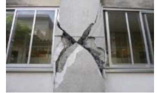
耐震化未完了の建物が大規模地震で甚大な被害を受けた例
