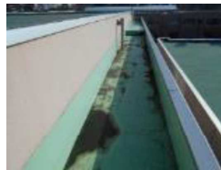
屋上防水の劣化
