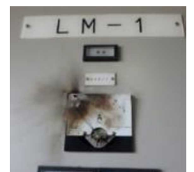
配電盤がショート
