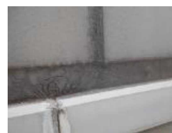
外壁タイルの浮き
