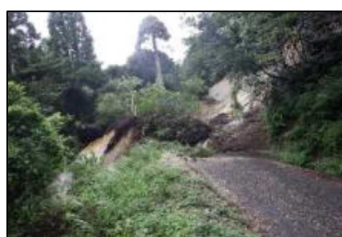
大雨による林道崩落
