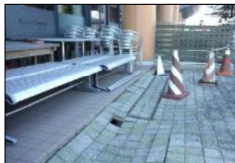
地震による外構破損
