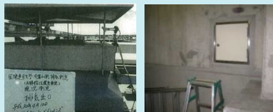
空調等換気塔の機能維持
