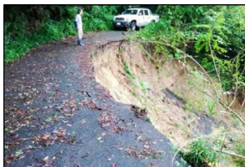
大雨による法面崩壊
