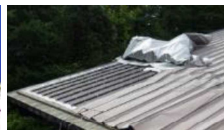
体育館屋根が損傷（漏水が発生）
