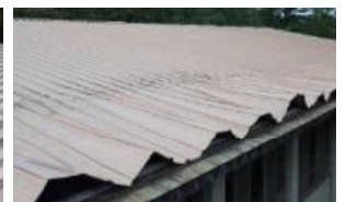
屋根全面が波打っている
