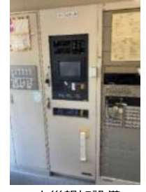
火災報知設備
