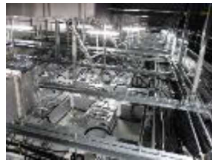
高浄度空調更新
