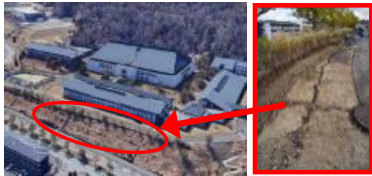
構内道路に発生した地割れ
