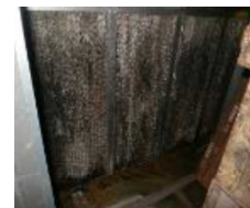
加湿器濾過材の整備
