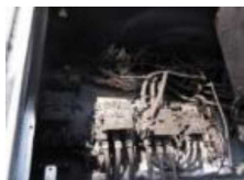
空調（チラー）の配線劣化による焼損
