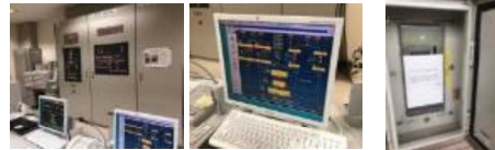
中央監視システム
