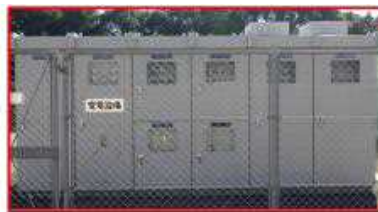
給水施設受変電施設
