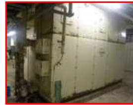
JT-60整流器棟空調機
