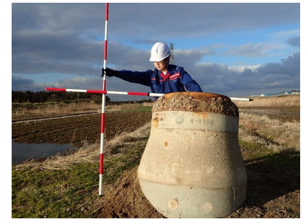
下水道管路災害(マンホール浮上) 中能登町(国土交通省HPより)
