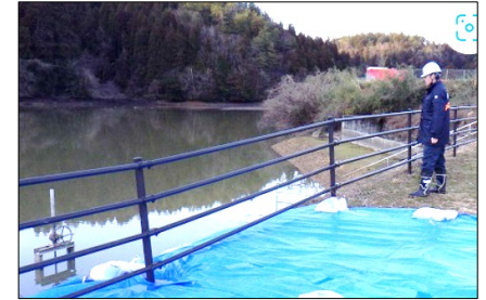
農業施設被災(ため池堤体) 珠洲市(農林水産省HPより)
