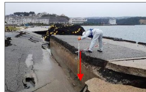
港湾施設被災(液状化・沈下) 能登町宇出志港(国土交通省HPより)
