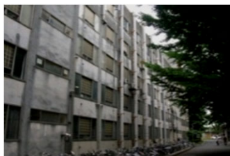
落下の危険がある外壁
