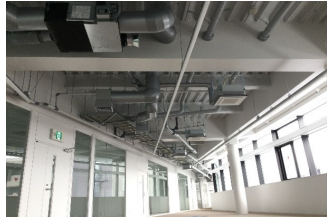
高効率空調の整備
