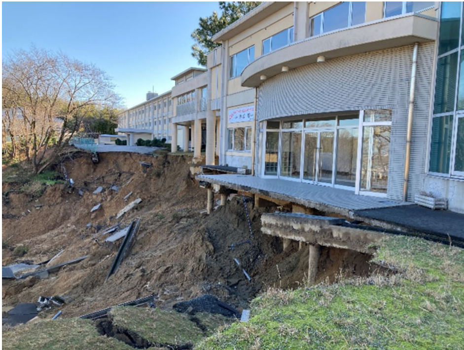
校舎前地盤が崩れ、地中杭が露出
