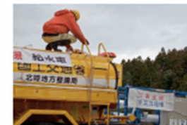
可搬式浄水装置を活用した 給水活動
