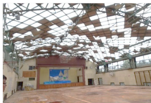
台風で屋根が消失した体育館
