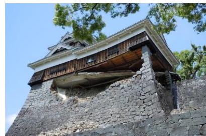
大型地震により石垣が崩壊 【特別史跡 熊本城跡 (熊本県熊本市)】
