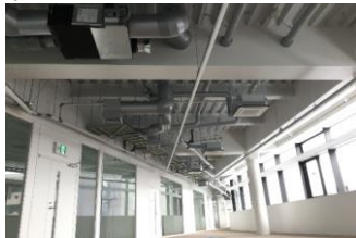
高効率空調の整備
