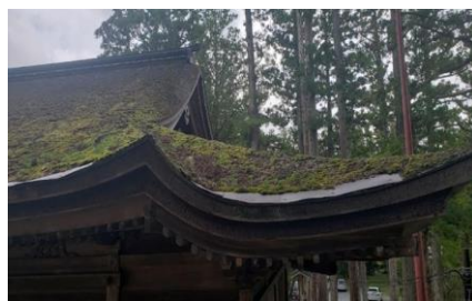
屋根を苔が覆い、葺材の劣化が進行 【国宝 金剛峯寺不動堂 (和歌山県高野町)】
