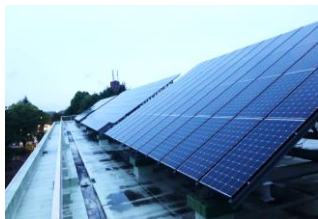
創エネルギー設備の整備
