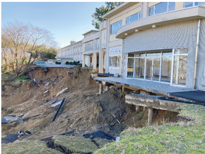
がけ崩れにより校舎を支える基礎杭が露出した 石川県立金沢北陵高校の被害写真
