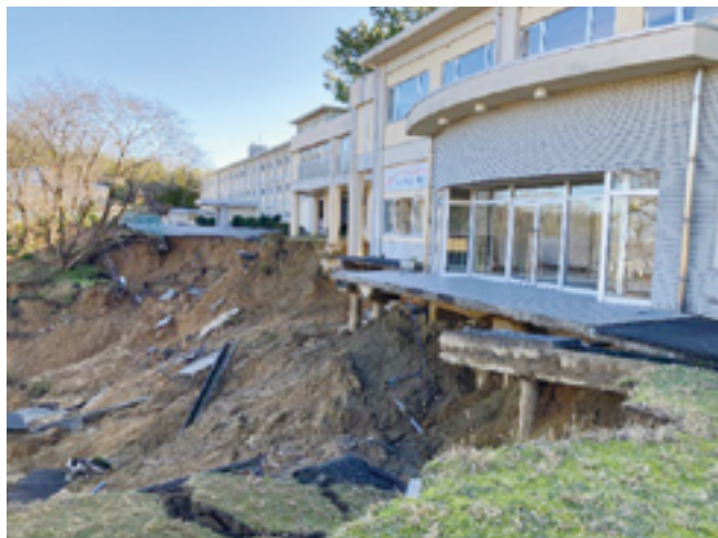
がけ崩れにより校舎を支える基礎杭が露出した 石川県立金沢北陵高校の被害写真
