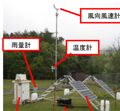
データ通信機器 バッテリー ソーラーパネル
