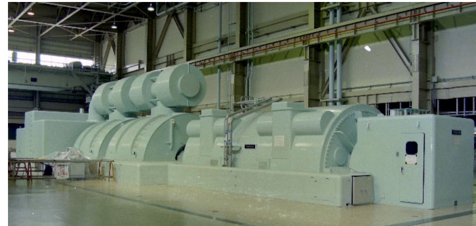
タービン発電機
