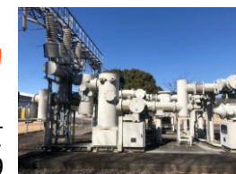
特別高圧受変電設備
