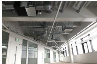
高効率空調の整備
