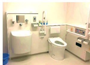
バリアフリートイレの整備
