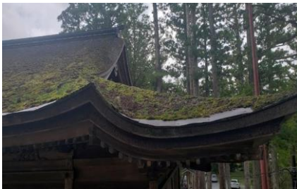
屋根を苔が覆い、葺材の劣化が進行 【国宝 金剛峯寺不動堂 (和歌山県高野町)】
