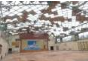
台風で屋根が消失した体育館
