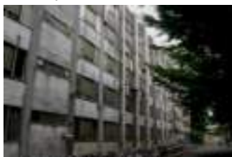
落下の危険がある外壁
