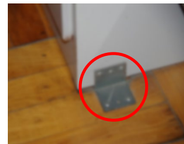
写真2. 棚の下部を床に固定した例
