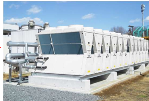
新設チラー (モジュールタイプ)
