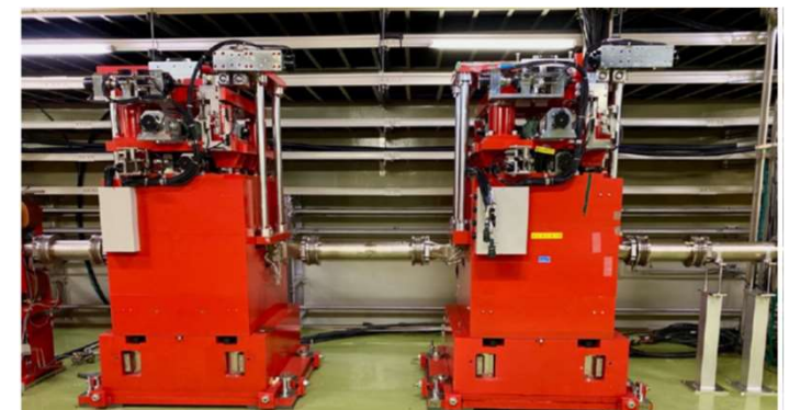
図: トンネルに設置したコリメータ
