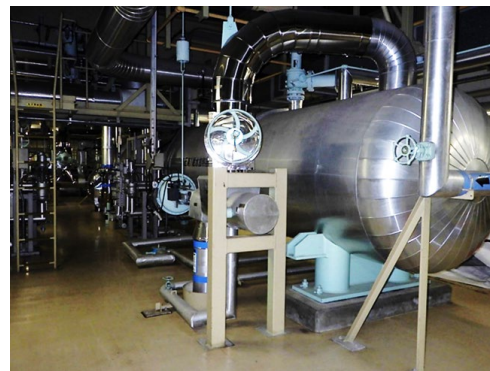
高圧給水加熱器
