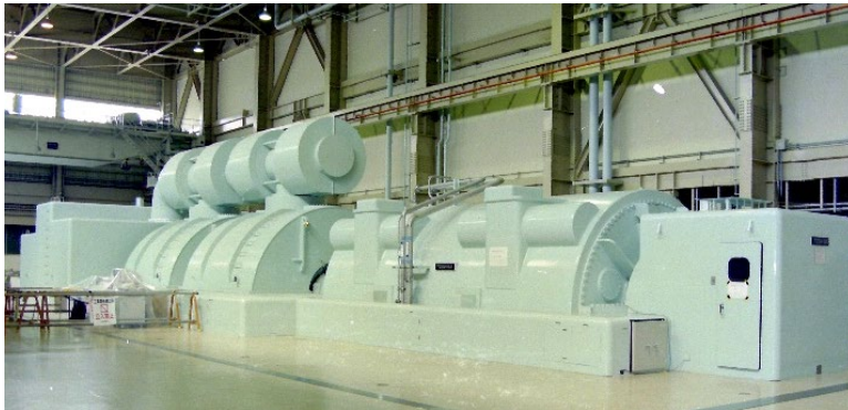
タービン発電機（タービン建物3階）
