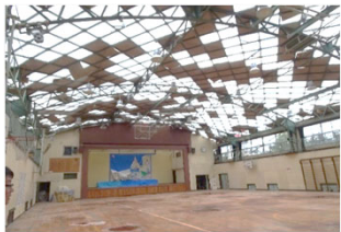
台風で屋根が消失した体育館
