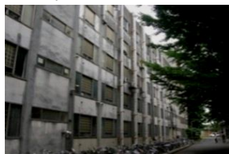
落下の危険がある外壁
