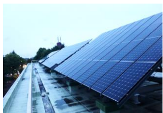
創エネルギー設備の整備
