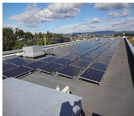
屋上に設置された太陽光パネル 設備容量：103kW
