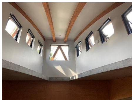
自然換気窓 (3階ホール)
