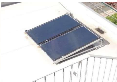
太陽熱集熱器 図工室・家庭科室の給湯に利用
