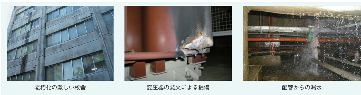
図表 2-12-6 国立大学等施設の老朽化状況
