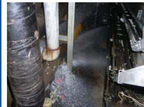
配管の破損による 水漏れ
