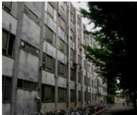
外壁の落下の危険
