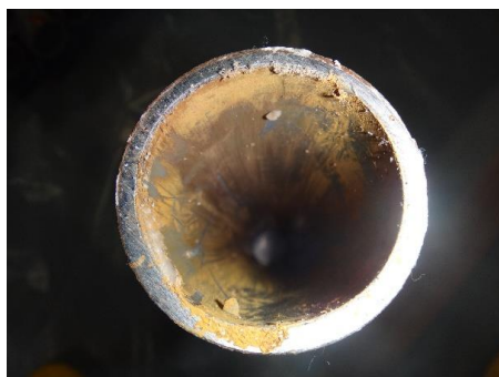
排水管内部剥離前
