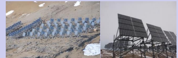
昭和基地に設置されている太陽光パネル群
