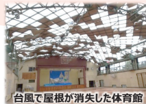
台風で屋根が消失した体育館
