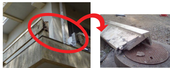
老朽化により手すりが落下
