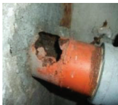
劣化による配管破損
