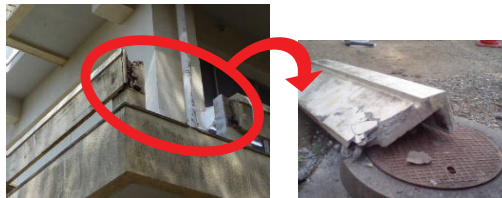
老朽化により手すりが落下
