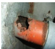
劣化による配管破損
