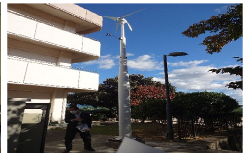
風力発電設備(蓄電器付) ワークショップで生徒が提案：かぜまるくん
