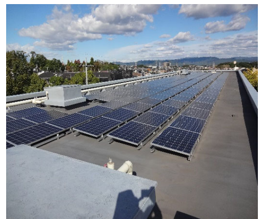
屋上に設置された太陽光パネル 設備容量：103kW
