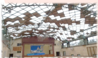
台風で屋根が消失した体育館
