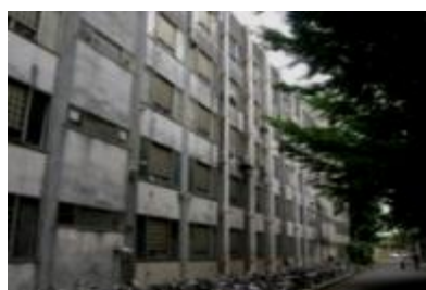
落下の危険がある外壁
