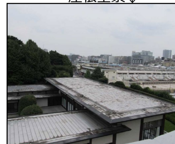
【現地調査（令和4年度）】 館内漏水状況→ 屋根全景↓
