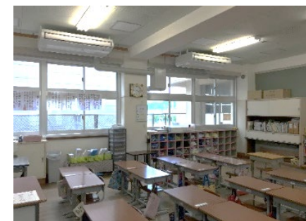
空調設備・換気設備を備えた教室
