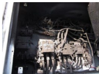
空調設備（チラー）の配線劣化による焼損
