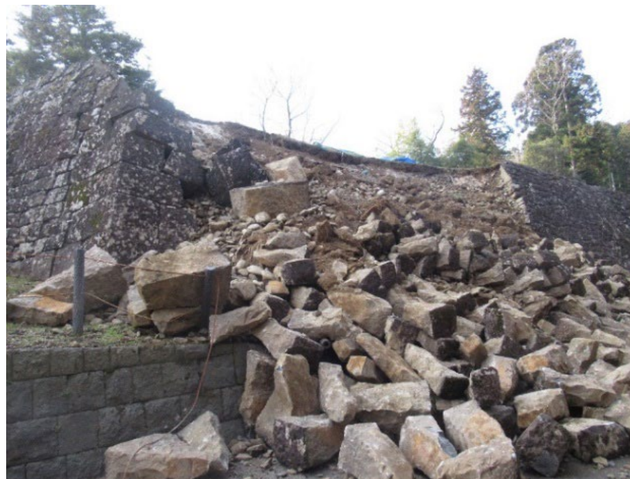
史跡 仙台城跡 （宮城県仙台市） 令和4年3月地震による被害
