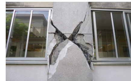
耐震化未完了の建物が大規模地震で甚大な被害を受けた例
