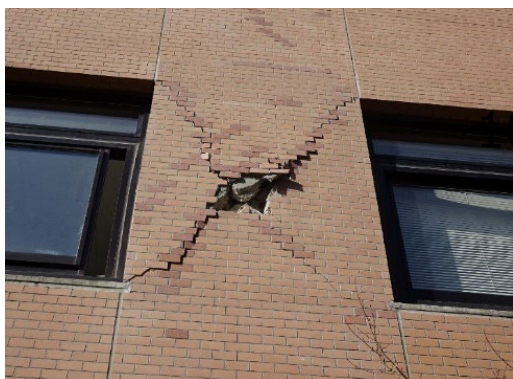
地震による建物外部破損
