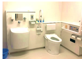
多機能トイレ等バリアフリー化により避難所としての防災機能を強化
