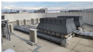
富岳：空冷チラーの増設
