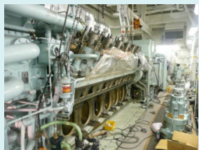
エンジン(発電機)
