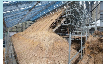
<建造物解体修理の様子> 重要文化財 天徳寺本堂ほか2棟（秋田県）
