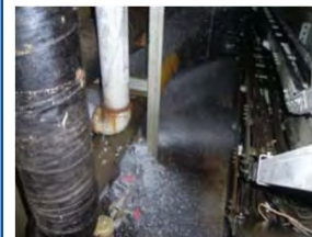
配管の破損による 水漏れ
