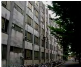
外壁の落下の危険
