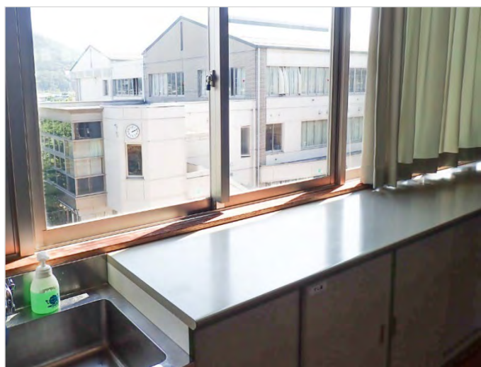
写真1 転落の危険のある窓（学校A）
