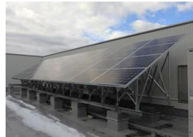
太陽光発電設備
