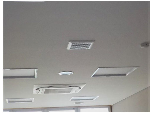
全熱交換換気システム
