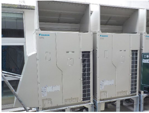
高効率ヒートポンプ空調
