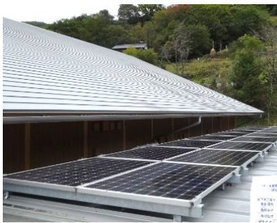
太陽光発電設備
