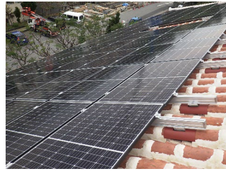
太陽光発電システム
