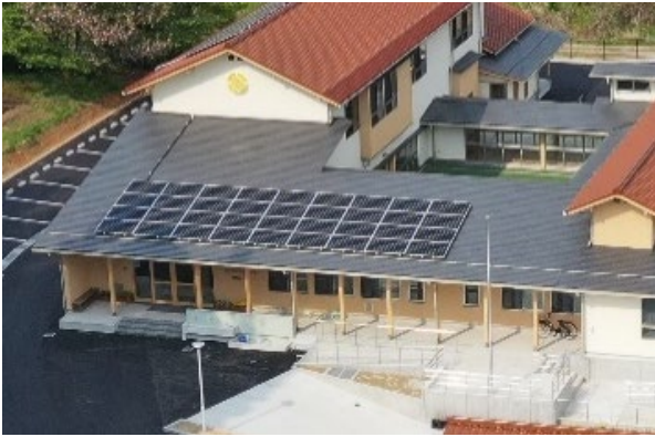
太陽光発電設備
