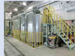
【5号処理プラント】
