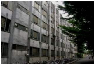
落下の危険がある外壁
