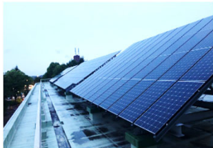
創エネルギー設備の整備
