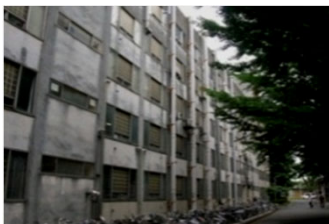
落下の危険がある外壁
