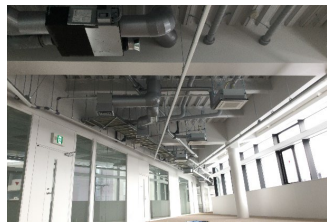
高効率空調の整備
