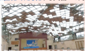
台風で屋根が消失した体育館
