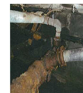
○給排水衛生設備
