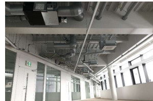
高効率空調の整備
