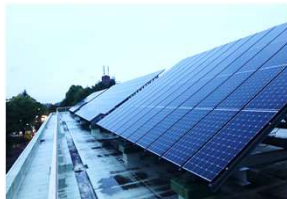
創エネルギー設備の整備
