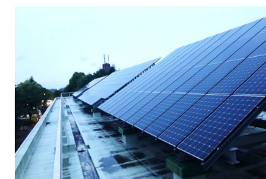
創エネルギー設備の整備
