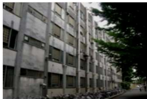
落下の危険がある外壁
