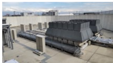
富岳：空冷チラーの増設
