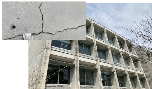
横浜研究所 外壁のひび割れ
