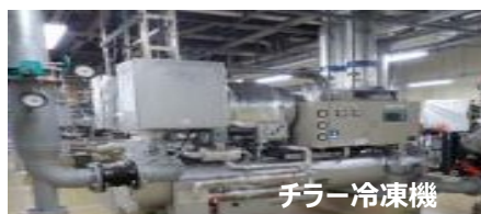
J-PARC：チラー冷凍機の改修・更新
