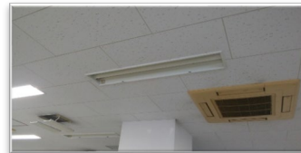
既存 空調室内機と照明器具
