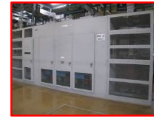
設置後35年以上を経 過したブースター電源
