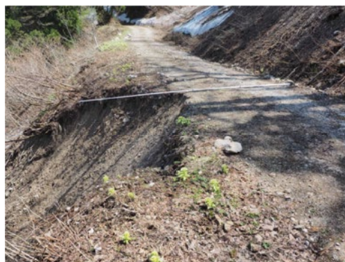
大雨による林道の土砂崩れ
