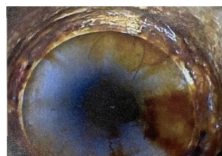
雑排水管 鉄部の腐食
