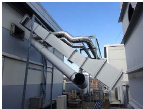
地震による建物設備破損
