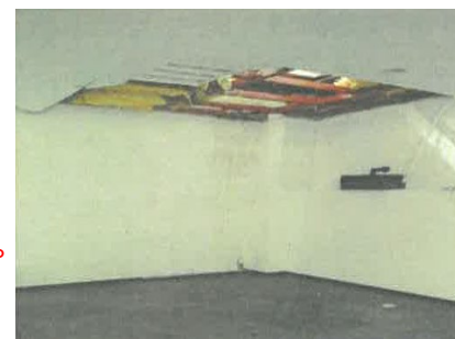
プレイホール棟2階PC室の天井材が一部崩落
