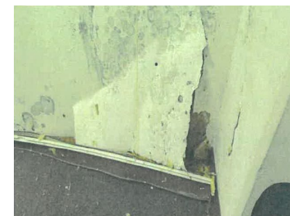
崩落した天井下の壁が浸水し、壁材の一部が損壊
