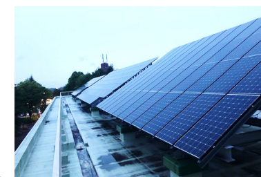
創エネルギー設備の整備
