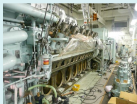
エンジン(発電機)
