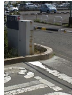
車路管制設備
