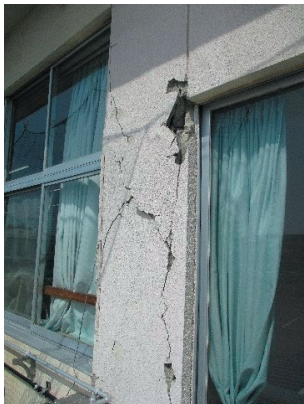
地震による外壁の亀裂
