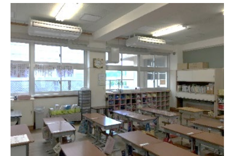
空調設備・換気設備を備えた教室
