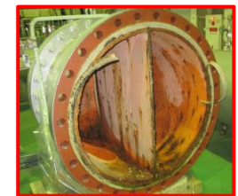
熱交換器 の内部
