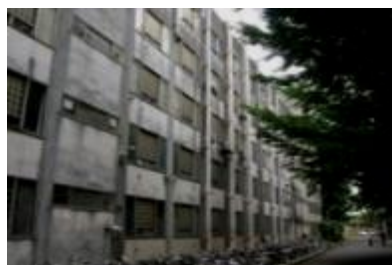
落下の危険がある外壁
