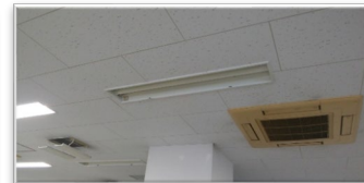
既存 空調室内機と照明器具
