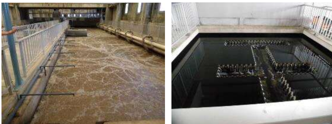
Fig.6 岐阜市下水処理施設の様子
