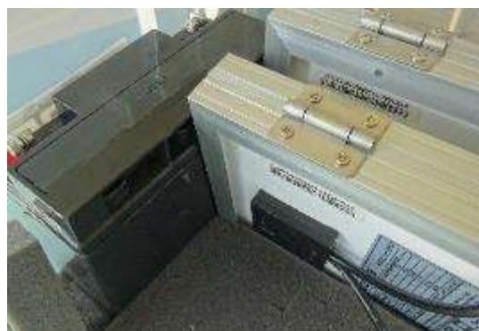
Fig 16 バッテリーを交換した
