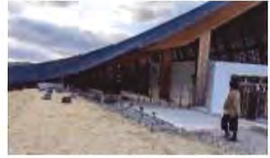
「雨どい」のない屋根
