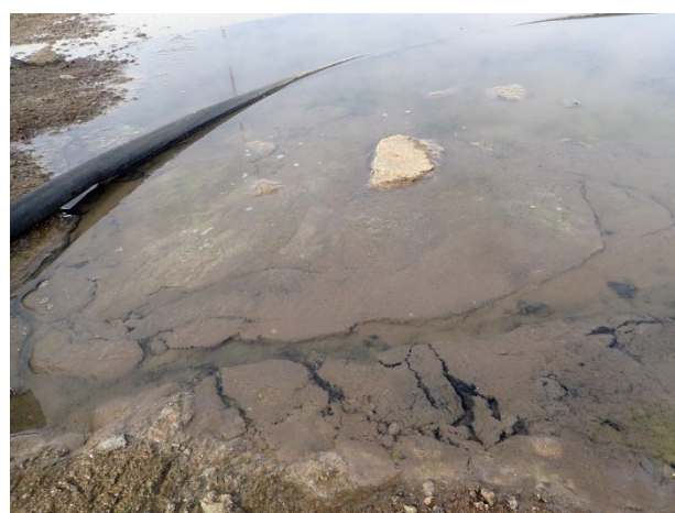
ヘドロ状の堆積物（処理水排出口周辺）
