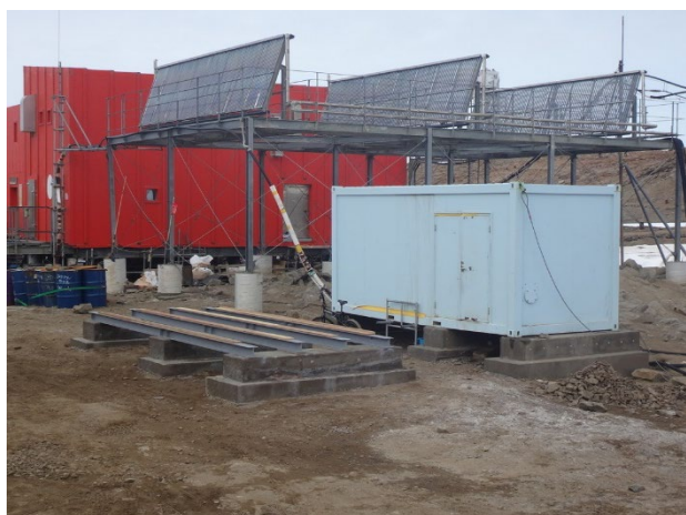
新型汚水処理装置（水色の建物）
