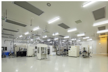
図4 クリーンルーム
