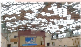
台風で屋根が消失した体育館
