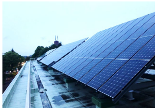
創エネルギー設備の整備
