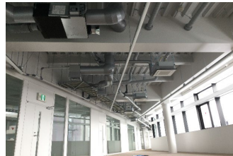
高効率空調の整備
