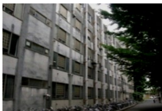
落下の危険がある外壁
